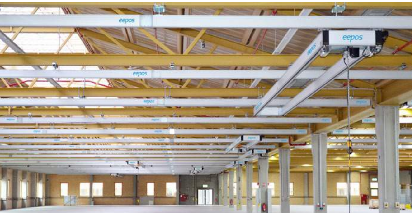
Bild unten: Produktionshalle mit Zweiträgerkranen Below: production plant with double girder cranes
